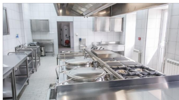
Fig. 10 Cocina del Hotel Humboldt
